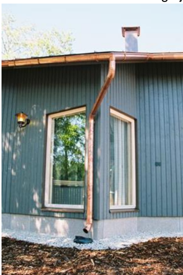
3. P13 vaskrenn ja 100 mm vasktoru
