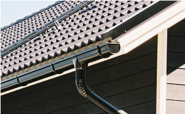
Bild 1. P13 ränna med utvändigt fäste och stuprör
